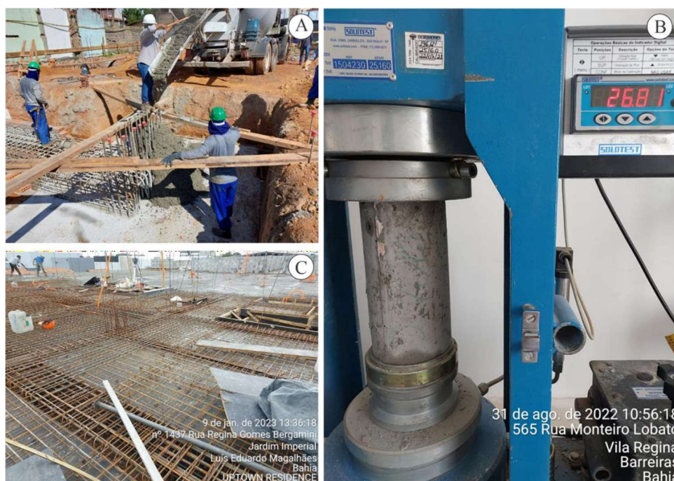
Figura 3 Fotografias da obra: A - Chegada do caminhão concreto, concretando fundação; B – Prensa manual rompendo corpo de prova, a prensa utilizada segue as normas da ABNT NBR ISO 7500-1; C – Concretagem da laje.
