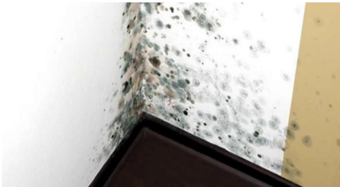
Figura 8: Superfície com presença de mofo.
