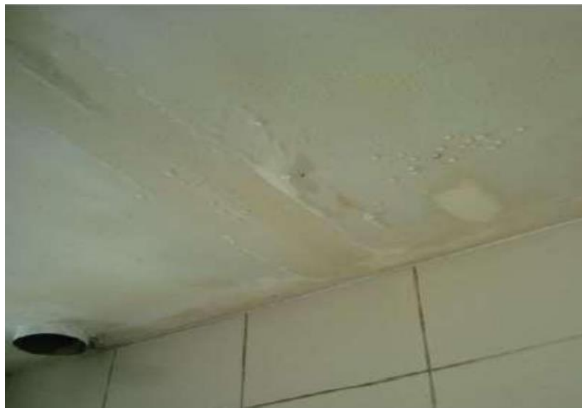
Figura 5: Vazamento de tubulação no forro.
