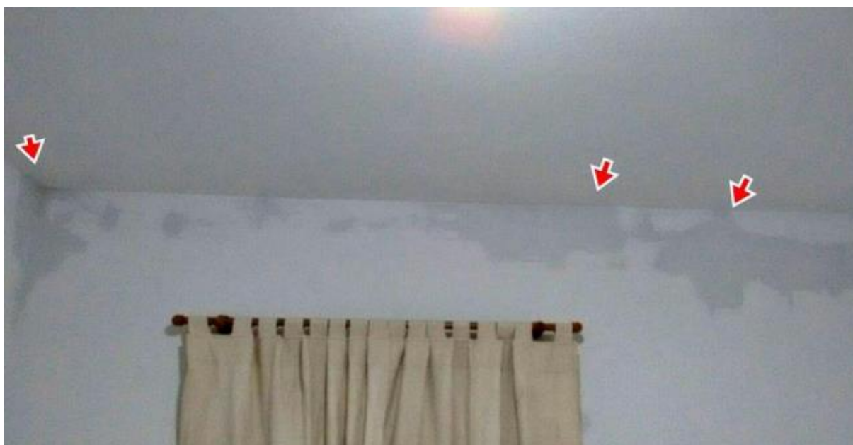
Figura 9: Manchas de umidade na parede.
