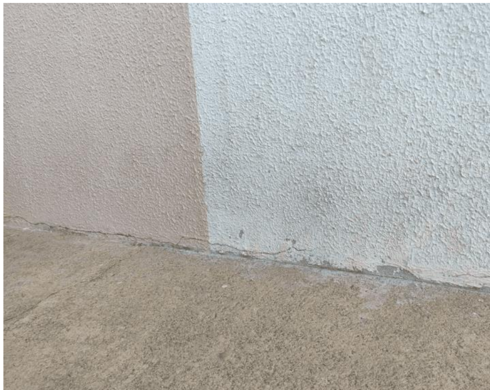
Figura 7: Fissura no rodapé da parede.
