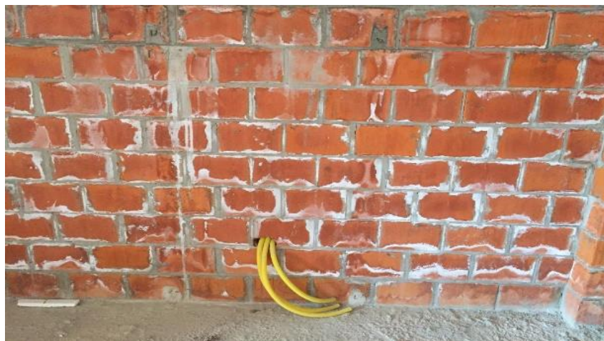
Figura 6: Eflorescência em blocos cerâmicos.
