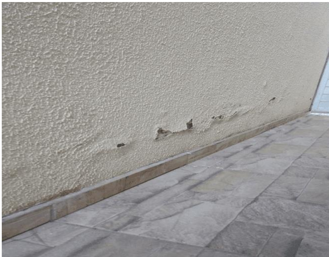
Figura 10: Descascamento na pintura.
