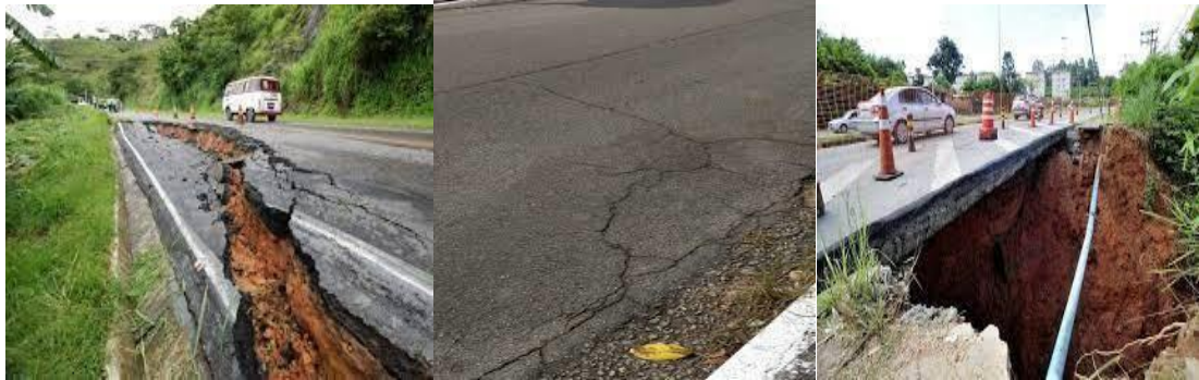
Figura 10: Erosão do solo, erros e falhas na pavimentação
