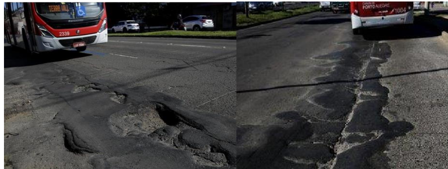
Figura 11: Deformações irreversíveis no asfalto borracha
