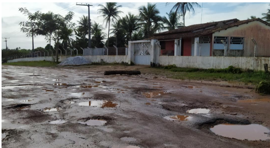
Figura 5 – Pavimentação asfáltica em péssimo estado durante período chuvoso.
