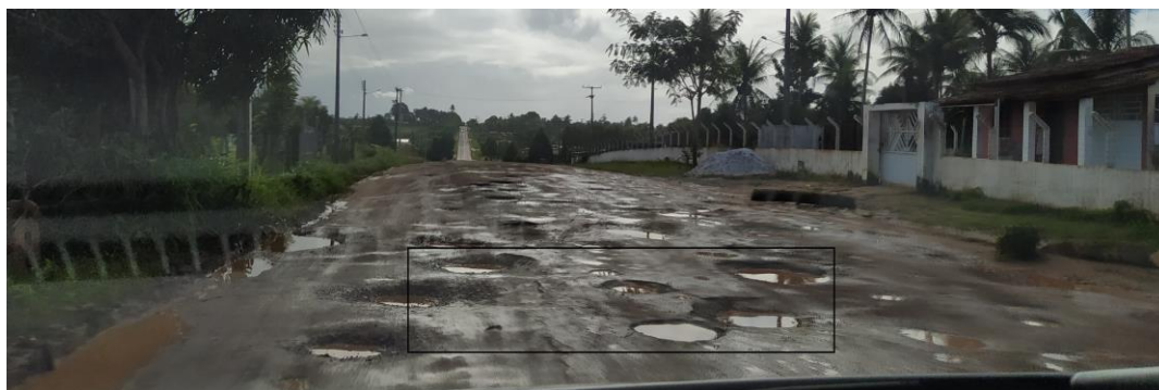
Figura 18 – Painelas em trechos da BA 396 Rio Real – BR 101
