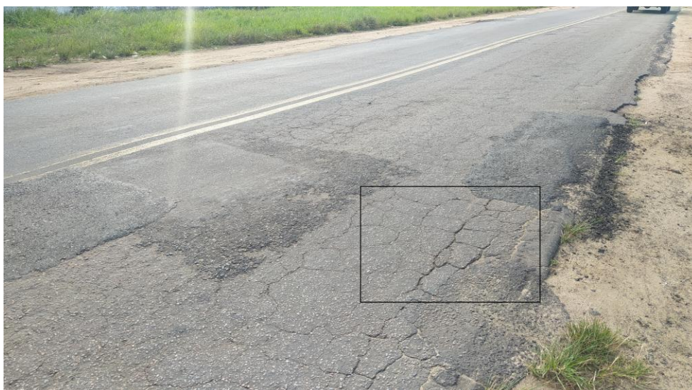
Figura 22 – Trinca tipo “Bloco” com erosão nas bordas.
