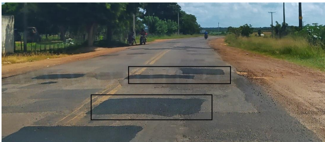
Figura 25 – Remendo de panelas no trecho da BA 396 que liga Rio Real – BA à BR 101
