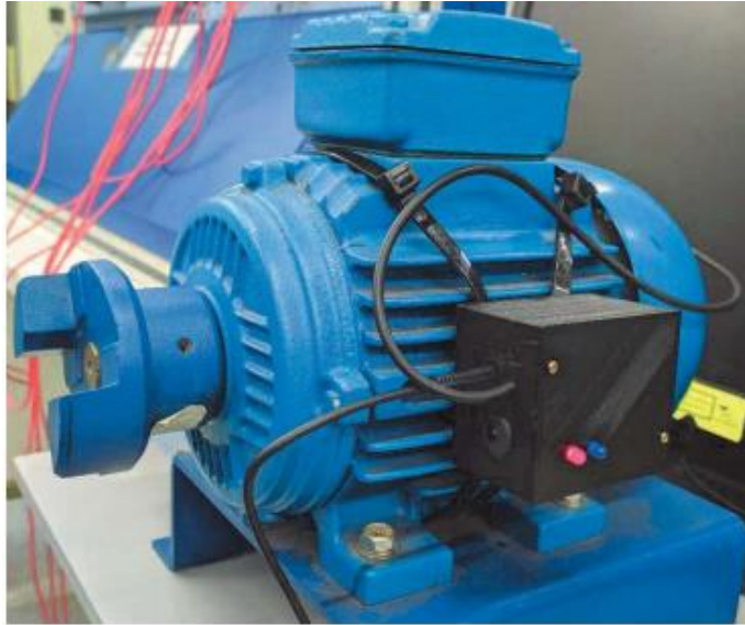
Figura 13. Protótipo de coleta de dados instalado no motor.
