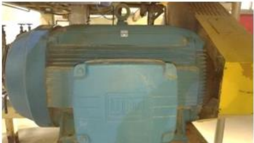
Figura 14. Sensor WEG acoplado a Motor
